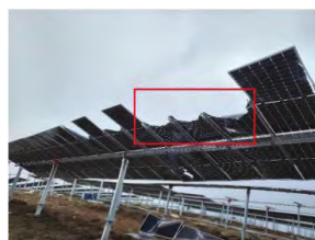
c. 光伏组件脱落、折断
