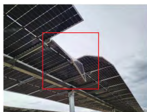
b. 光伏组件破坏
